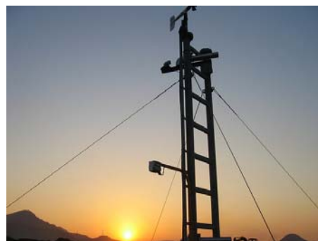
図1 綾川町に設置している水文・気象観測装置
